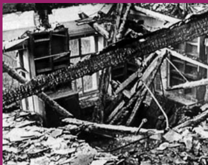
La charpente effondrée de la bibliothèque n°2
